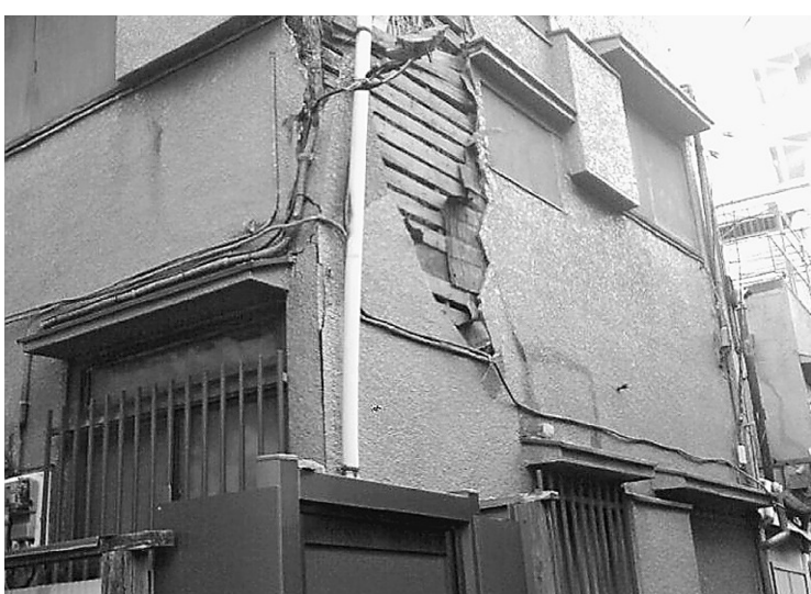
地震で外壁がはげ落ちた荒川区南千住の民家
