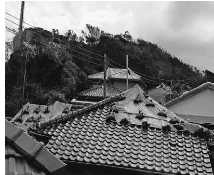
実際に見る台風の被害の様子
